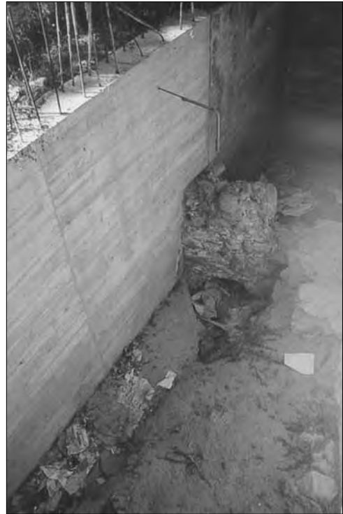
Lámina 14.1. Tepidarium I. Estado inicial.
