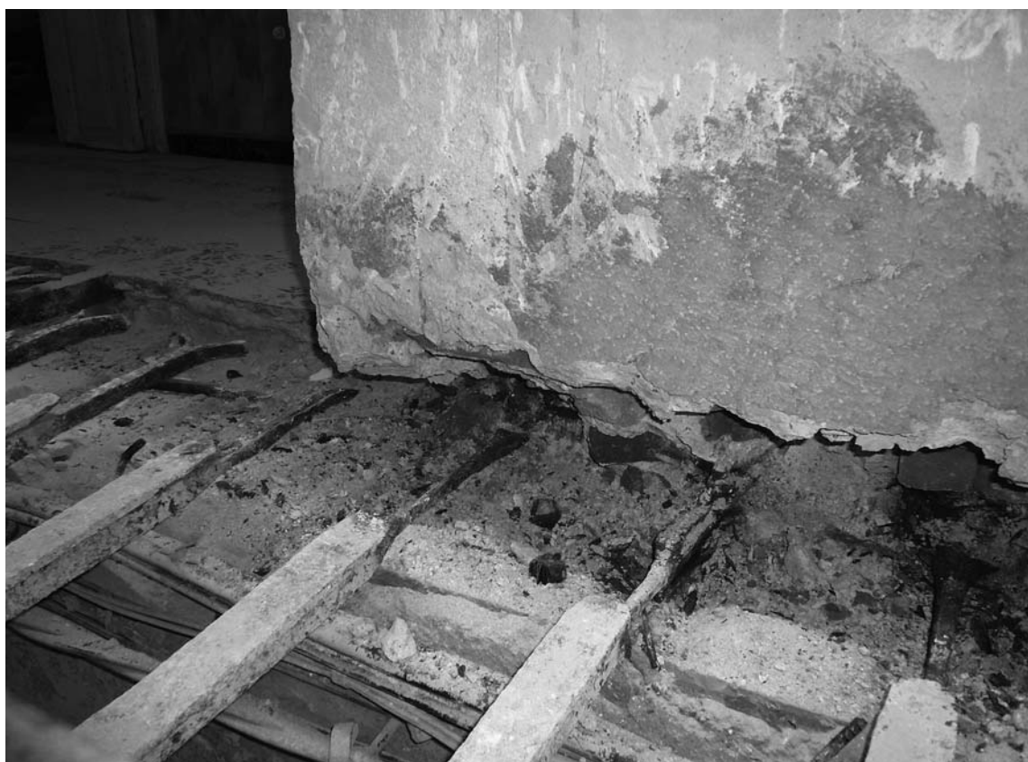
Imagen 2. Detalle losa de balcón con pérdida total de sección en viguetas metálicas. Edificio en C/. Villamartín, n.º 5.
