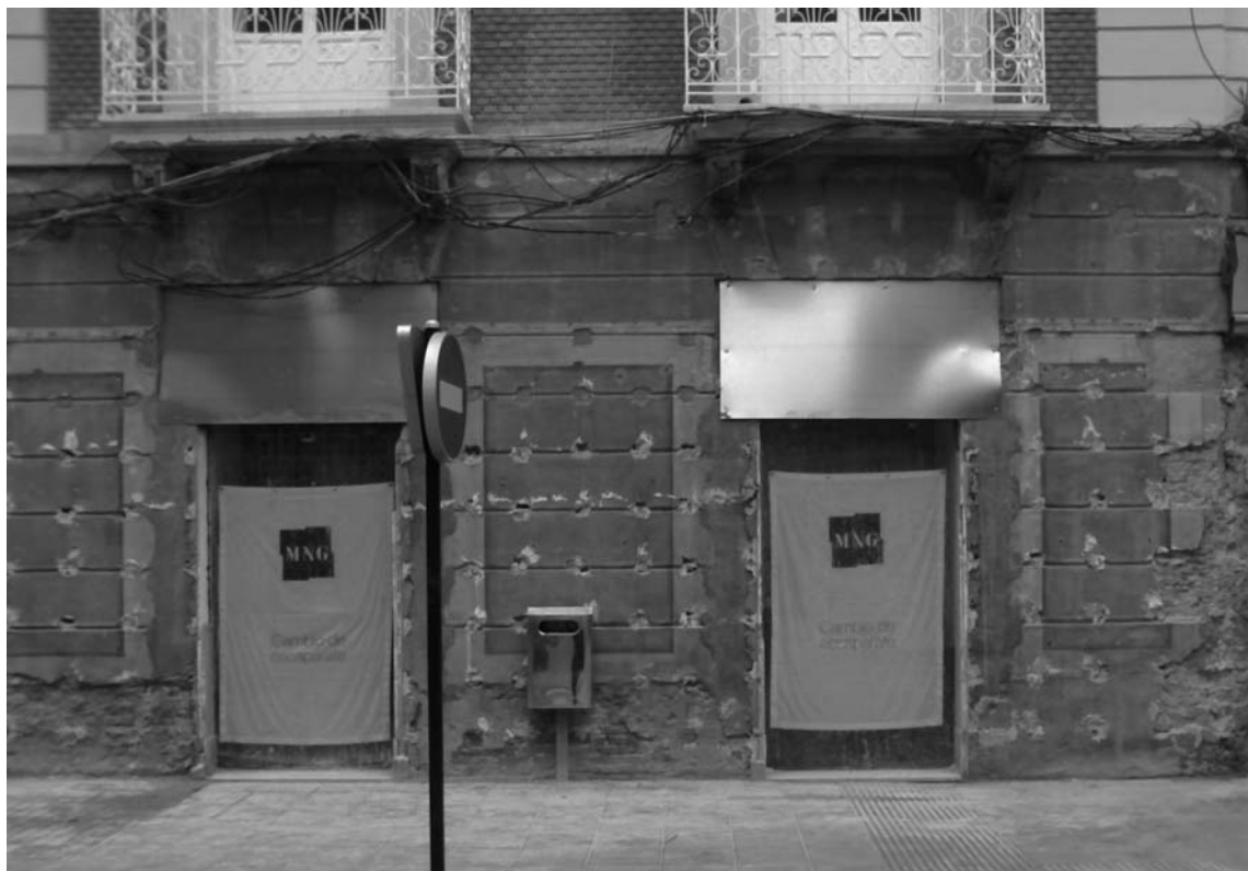
Imagen 7. Aparición de revoco pétreo original, con almohadillado, tras eliminar aplacado superpuesto. Edificio en Plaza de Castellini, n.º 13.
