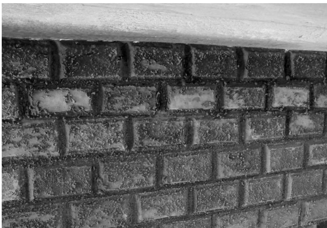
Imagen 3. Detalle ensuciamiento de ladrillo por pinturas anteriores. Edificio en C/. Palas 12.
