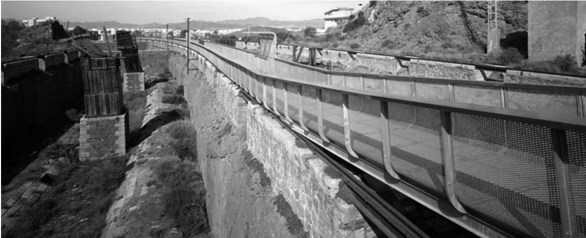
Figura 6. Vista general de la intervención sobre el antiguo cargadero de mineral (foto: David Frutos).
