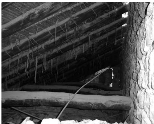
Figura 4. Se puede apreciar la estructura de madera y los muros de carga de mampostería.
