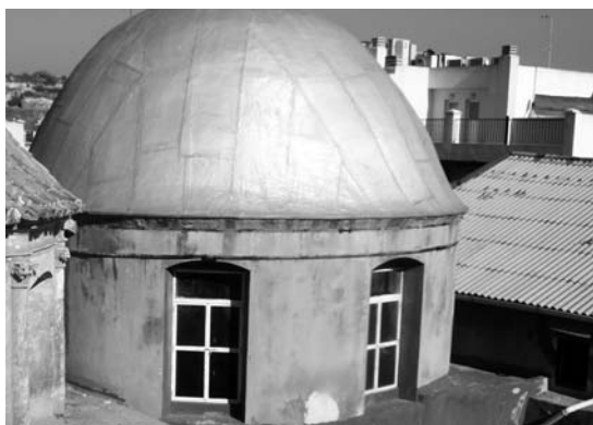
Figura 5. Detalle de la cúpula de la Capilla del Sagrado Corazón de Jesús, recubierta con lámina impermeabilizante auto-protegida de aluminio.
