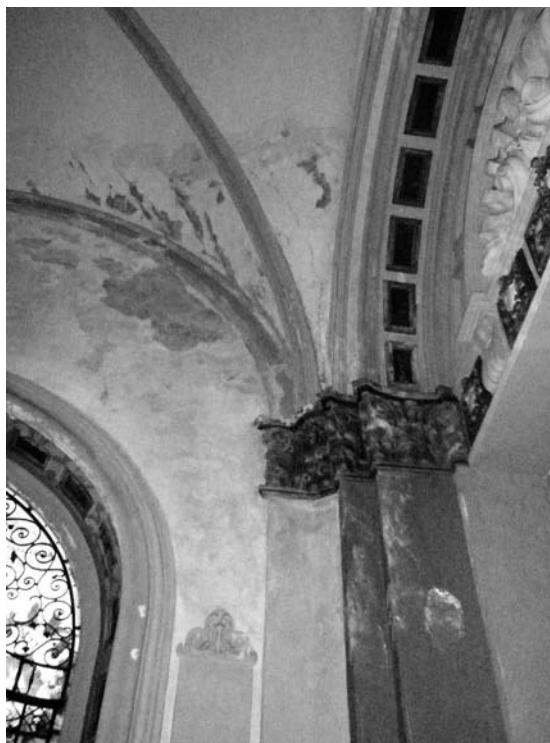
Figura 13. Muestra de la humedad por filtración en una de las pilastras del Templo. Se aprecia la corrosión de la pintura dorada, la proliferación de microorganismos y la aparición de eflorescencias entre otras patologías.
