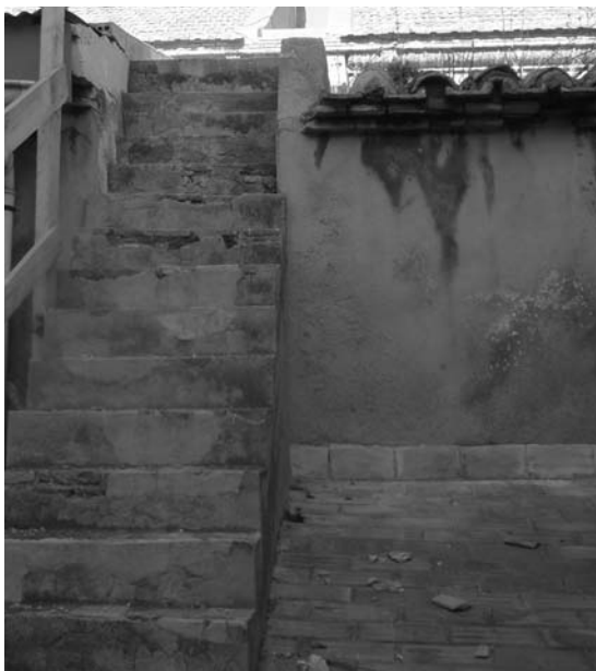
Figura 9. Ejemplo del estado de la cubierta de la Iglesia de Santa María de Cartagena. Se aprecia humedad, disgregación, eflorescencias, suciedad, microorganismos y plantas superiores entre otras patologías, consecuencia del mal mantenimiento.
