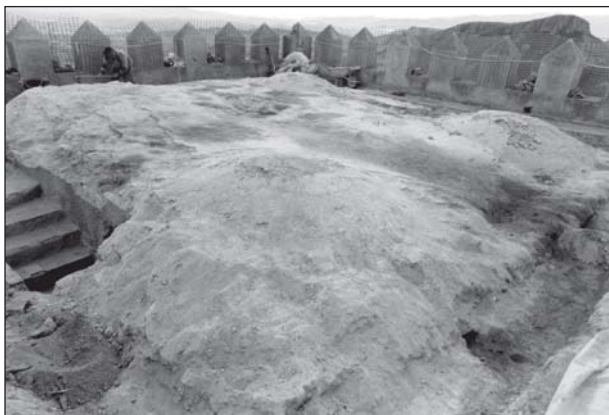
Figura 17. Torre del Homenaje. Terrado original del edificio. Se observa la importante caída de la cubierta hacia el oeste. Vista desde el noroeste.
