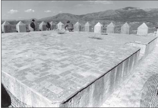
Figura 14. Torre del Homenaje. Terrado. Aspecto previo a la intervención. Vista desde el sureste.
