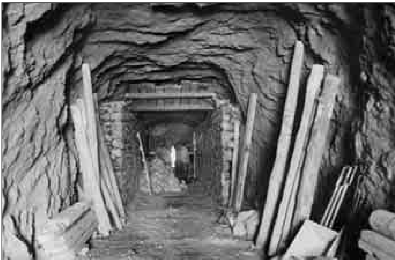
Lám. 106: Parte de las complicadas obras fue el abrir los diferentes túneles y subterráneos que formarían parte de los repuestos, ascensores y otras dependencias de las baterías establecidas en las alturas de la llamada Sierra Minera.
