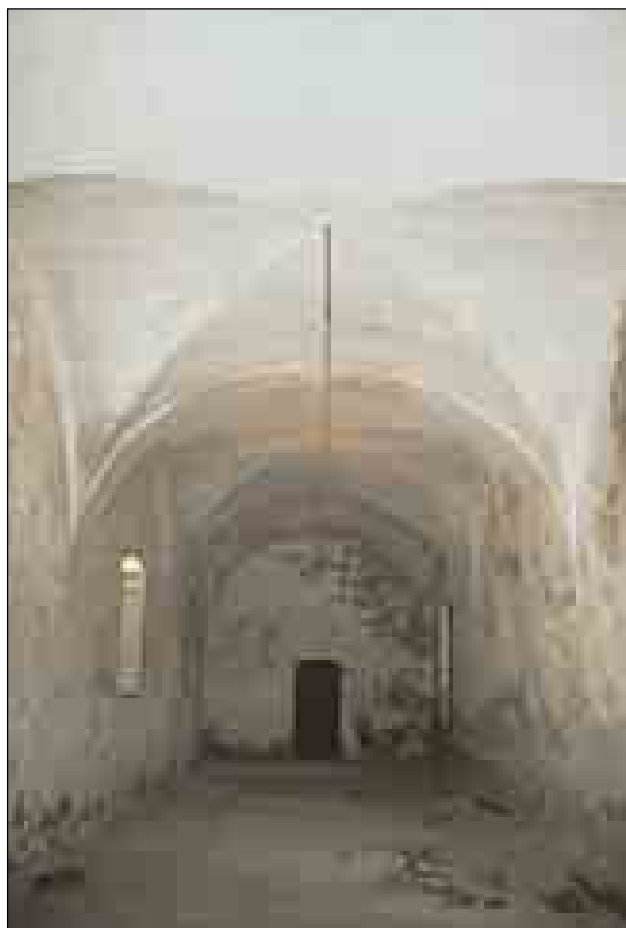
Lám. 73: Los espacios en el Cuartel Defensivo Fajardo son enormes, con unas espléndidas bóvedas de crucería que sujetan el primer piso. No obstante, tras años de abandono, su estado de conservación comienza a ser más que preocupante.
