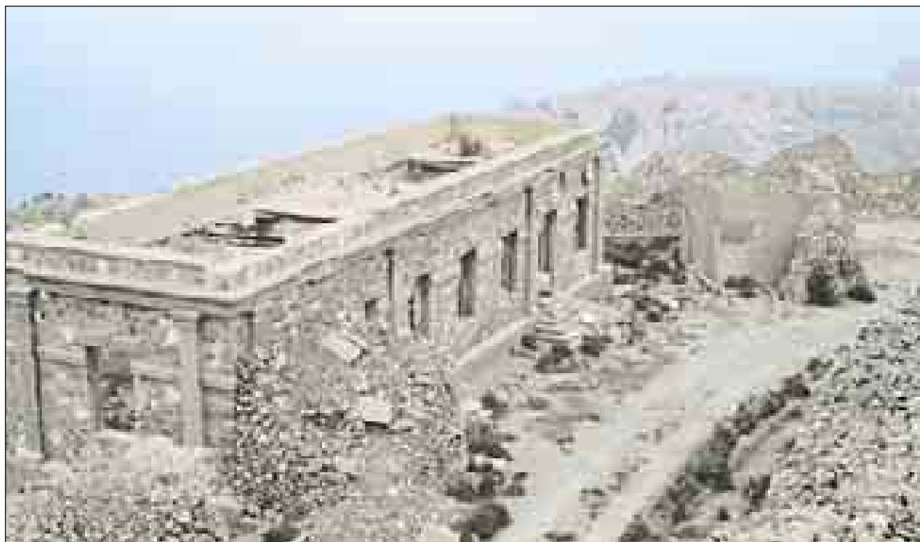
Lám. 194: Son muchas (por no decir todas) las edificaciones de las baterías costeras que actualmente corren grave riesgo de mayor degradación tras años de abandono y expolio.
