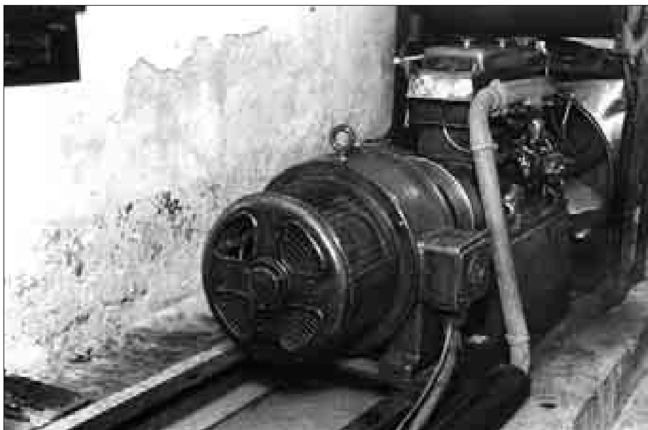
Lám. 151: Los proyectores de costa y antiaéreos se servían de grupos electrógenos que les permitían cierta autonomía y potencia.
