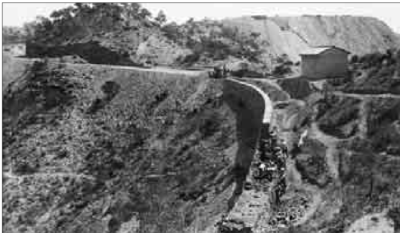
Lám. 101: Hubo, como no, que levantar grandes muros de contención para la sujeción de la carretera, en este caso, en el monte de Cenizas.
