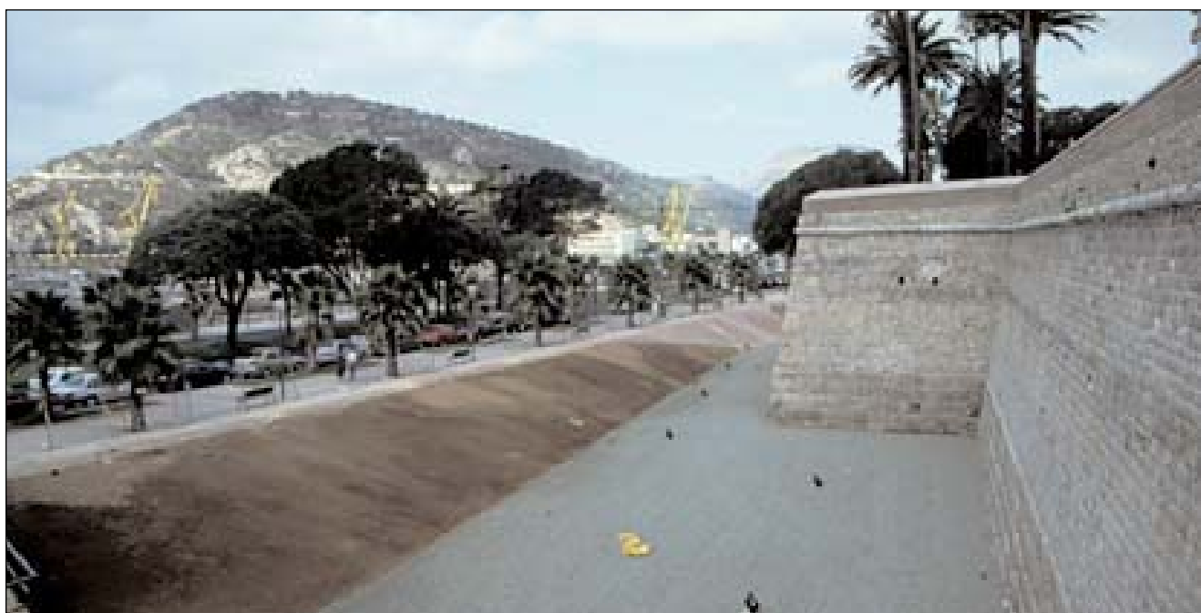
Lám. 42: Fue el frente marítimo el último tramo que se levantó de muralla durante los últimos años de la década de los ochenta del siglo XVIII. La muralla, muy transformada en los últimos años, presentaba una estructura muy sólida, utilizando piedra careada en toda su extensión y desechando el atabaire que había sido empleado algunos tramos de los frentes de Benipila y el Almarjal. Su coronamiento fue siempre a barbata, y nunca tuvo merlones ni troneras, ya que la artillería se colocó algo más atrás de la primera línea y no era previsible la actuación masiva de fusileros. En este caso se dispuso una batería de cañones en primer lugar, cuya función era la de batir la entrada a la bahía, y una segunda fila de morteros para efectuar tiros curvos y cubrir el interior de la bahía. En la actualidad presenta un aspecto confuso en su conjunto, con un aditamento superior sobre la originaria barbata que la eleva de su altura original, dejando huérfanos a los pies de las garitas, y un vaciado inmediato de la base (que fue rellenada a finales del siglo XIX para construir el puerto de Alfonso XII) que contrasta con la altura del paseo, la carretera y el puerto, dando la falsa impresión de un foso que nunca tuvo.
