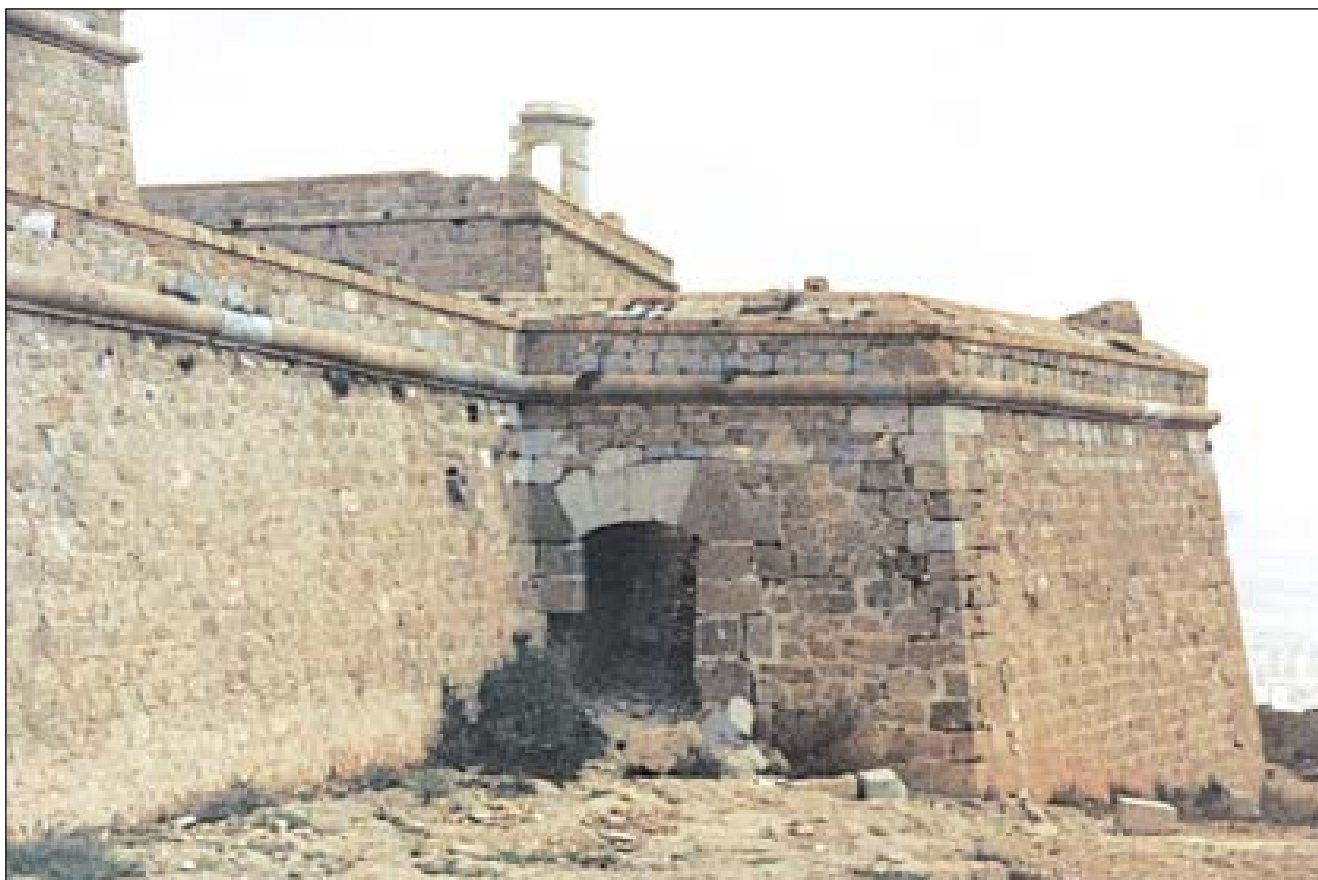
Lám. 64: El estado de conservación del fuerte de Atalaya no deja de resultar más que preocupante. En la imagen, una fotografía de la puerta tomada hace unos años, se aprecia la garita que coronaba el acuartelamiento y que por aquel tiempo aún subsistía muy deteriorada. Hoy ya no existe.
