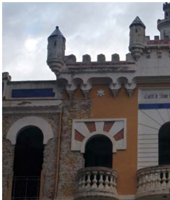
Figura 2. Detalle de la portada del Pabellón I durante los trabajos de rehabilitación.
