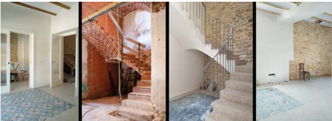
Figura 3. Vistas de distintas fases de obra de la vivienda en Vall d'Alcalà (Alicante).
