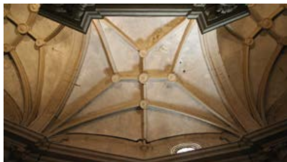
Figura 2. Desplazamiento muro en segundo tramo de girola. Colegiata San Patricio (Lorca).
