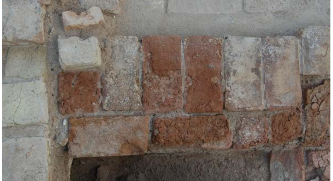
Figura 2. Degradación diferencial de ladrillos de distinto color.
