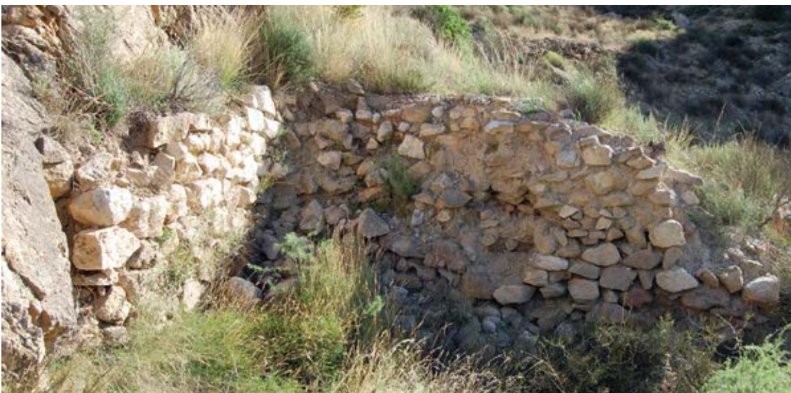
Figura 4. Estado de conservación inicial (Salto de la Novia-Ulea).
