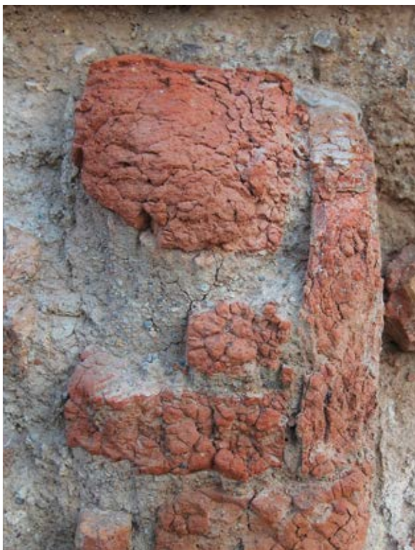
Figura 1. Degradación de ladrillos en el área estudiada de San Esteban (Murcia).
