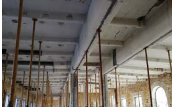
Figura 6. Apuntalamiento durante los trabajos de refuerzo estructural, en el segundo forjado del Pabellón I.
