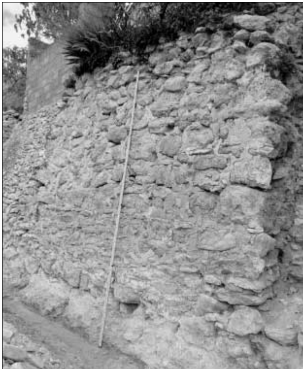
Lám. 6: Paseo de la Umbría , Bullas (Murcia). Contrafuerte. Aspecto de la cimentación de argamasa de cal. Refuerzos de sillarejo en los flancos .
