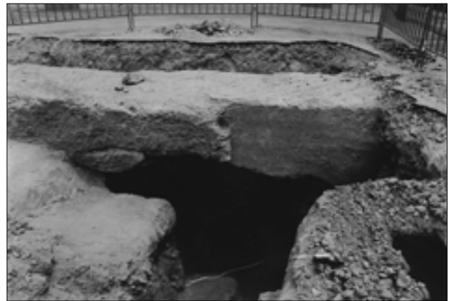
Lámina 2. El lienzo de muralla quedaba colgado por una intervención posterior a su construcción de época moderna.
