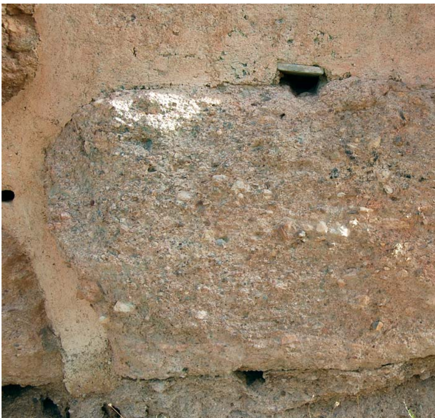
Estado inicial y final del graffiti nº 9
