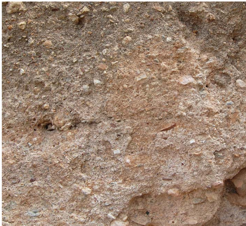
Estado inicial y final del graffiti nº 4
