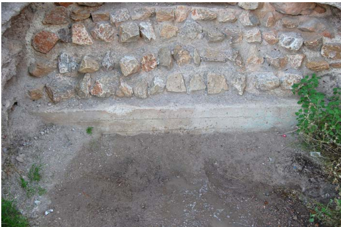
Estado inicial y final del graffiti nº 6
