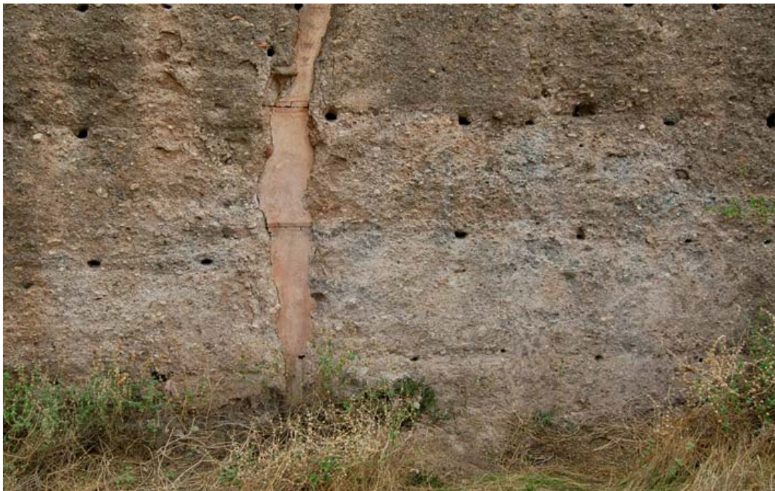
Estado inicial y final del graffiti nº 10
