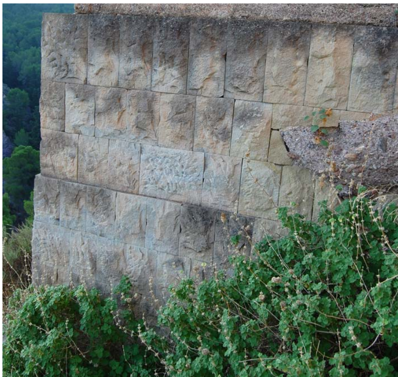
Estado inicial y final del graffiti nº 16
