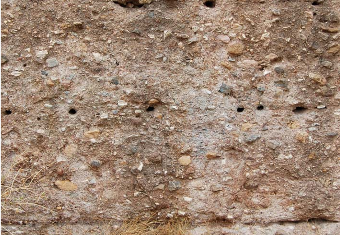
Estado inicial y final del graffiti nº 12
