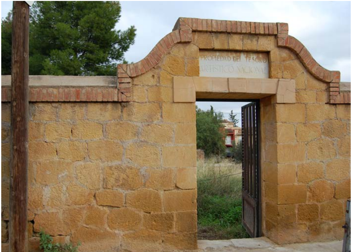
Estado final de la puerta de la valla histórica que da acceso al Martyrium
