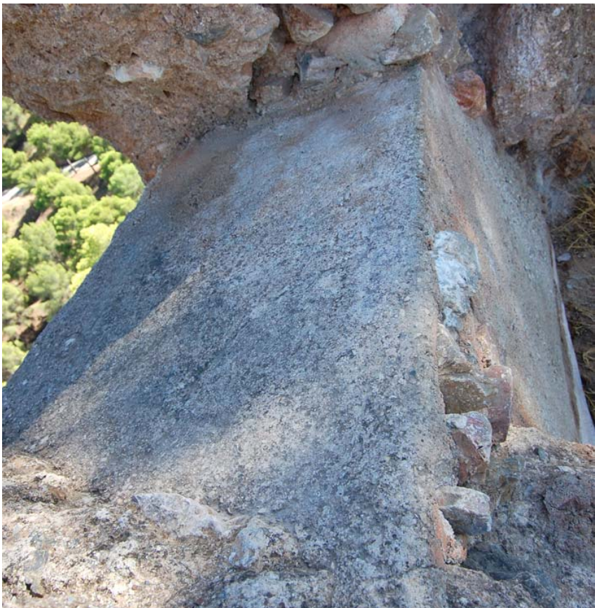
Estado inicial y final del graffiti nº 2
