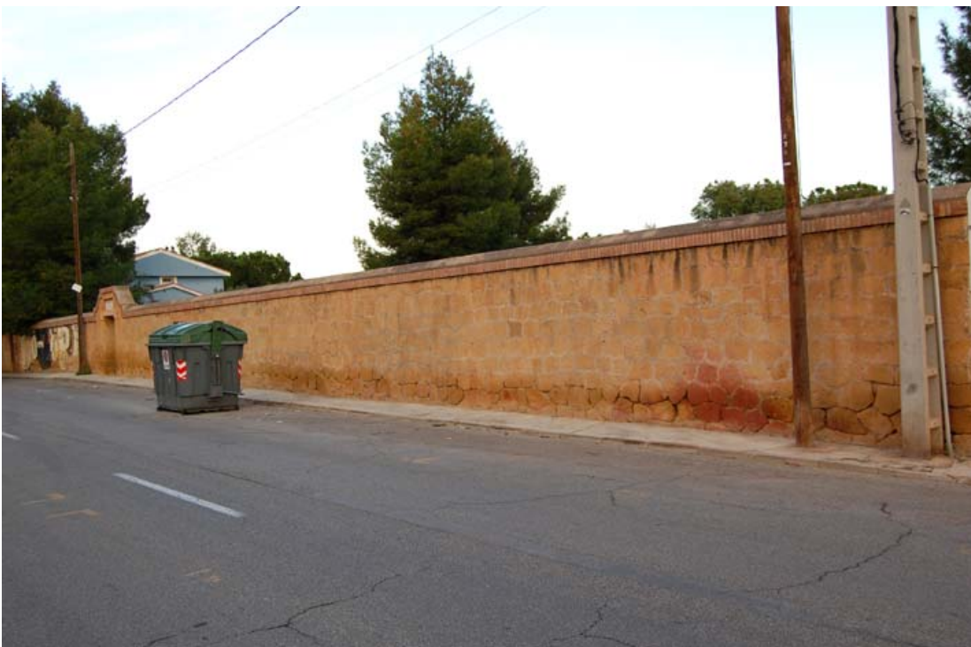
Estado final del lado derecho de la valla histórica
