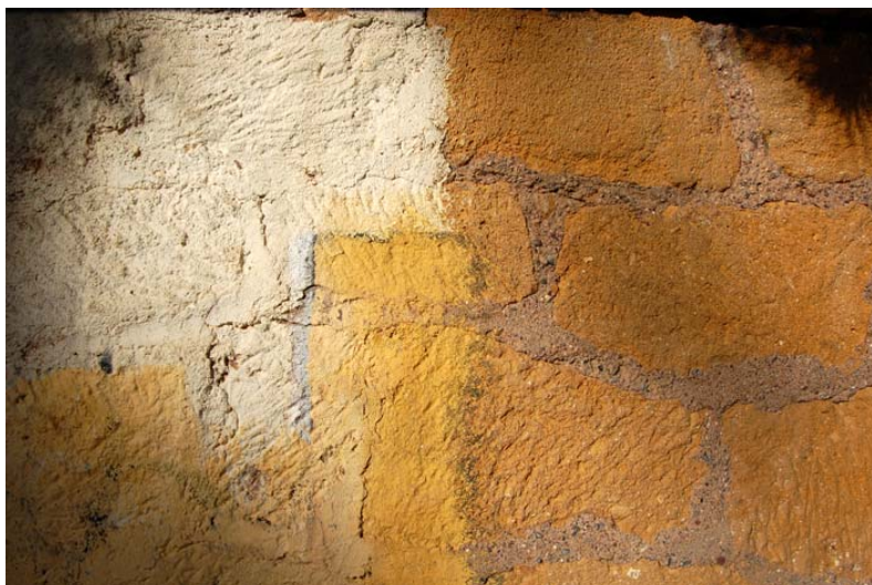
Proceso de eliminación de los graffitis del lado izquierdo de la valla histórica realizados con gruesas capas de pintura plástica
