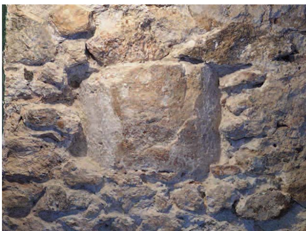
Lámina 3. Fuste de columna n.º 1, situado en el muro sur de la habitación de la planta inferior del antiguo Café-bar La Catedral.
