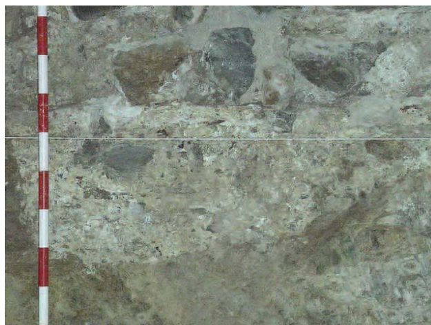
Lámina 7. Detalle del muro este de la habitación de la planta inferior del antiguo Café-bar La Catedral.
