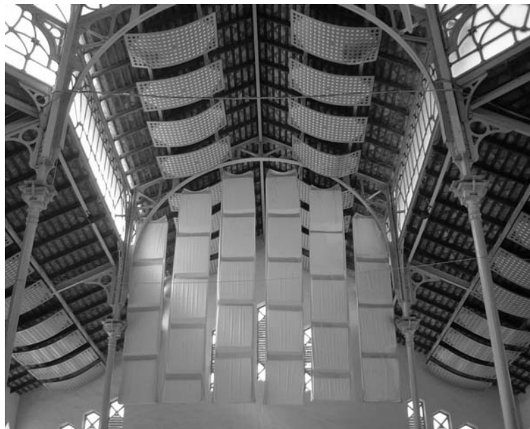
Lámina 10. Detalle de los elementos colocados para la mejora acústica del edificio según el Proyecto de Acondicionamiento Acústico del antiguo Mercado de Abastos de La Unión, redactado en 1997.
