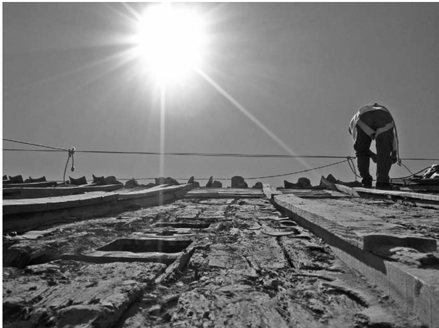
Lámina 8. Restauración de la sobrecubierta de la iglesia de La Concepción, en la que se puede observar el estado en que se encontraba el trasdós del artesanado de la iglesia.
