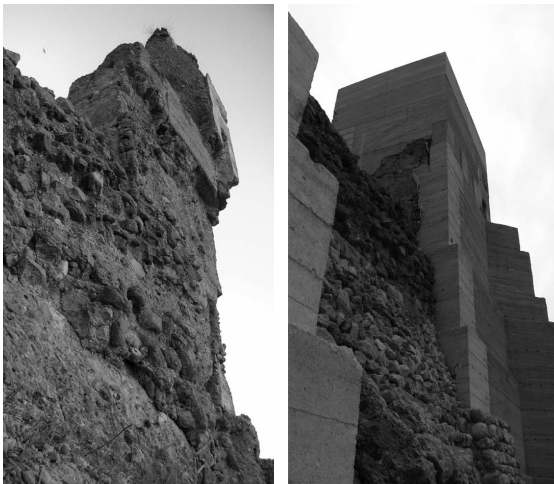
Láminas 7 y 8. Vistas desde el noroeste. La torre antes y después de las obras (FJLM).
