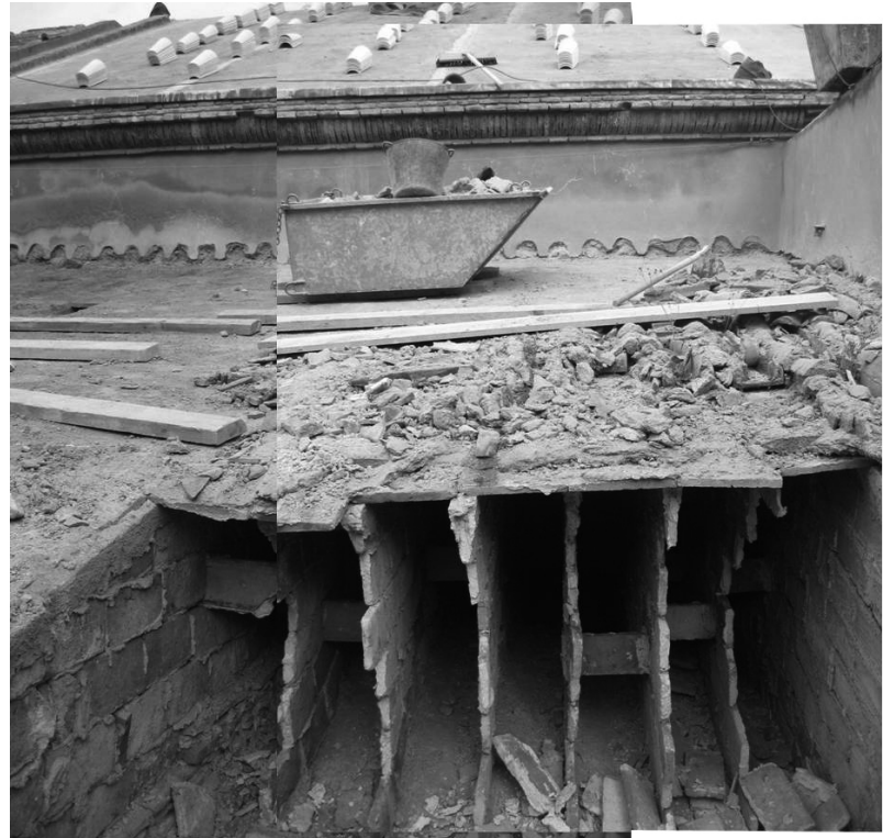
Lámina 1. Detalle del tablero que conforma el faldón de una de las cubiertas, colocado sobre unos tabiquillos palomeros absolutamente infradimensionados, lo que originaba muchas fracturas.
