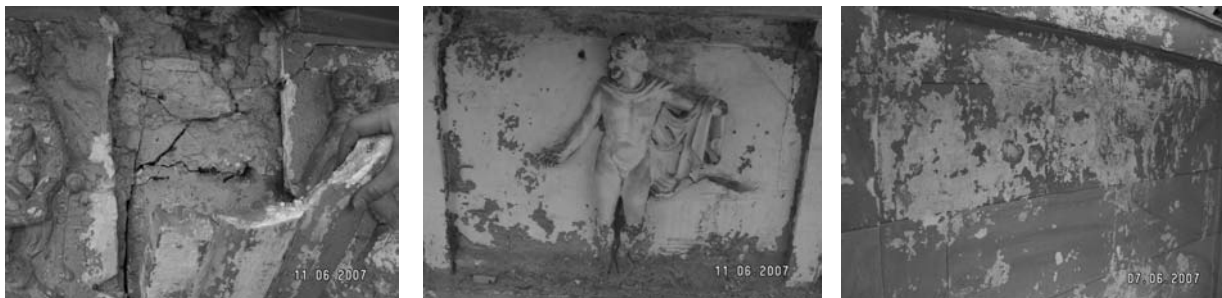
Láminas 7, 8 y 9. Estado inicial de los relieves, así como los paramentos lisos en el patio pompeyano.
