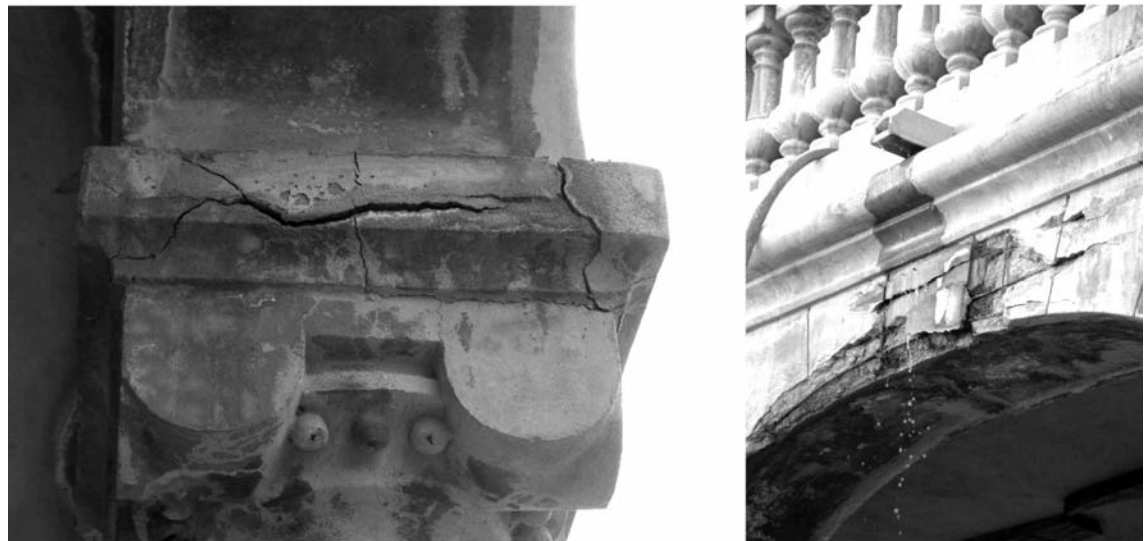
Lámina 6. A la izquierda, detalle del estado de conservación de uno de los capiteles de fachada. A la derecha, detalle de la patología producida por incidencia directa del agua sobre el arco.
