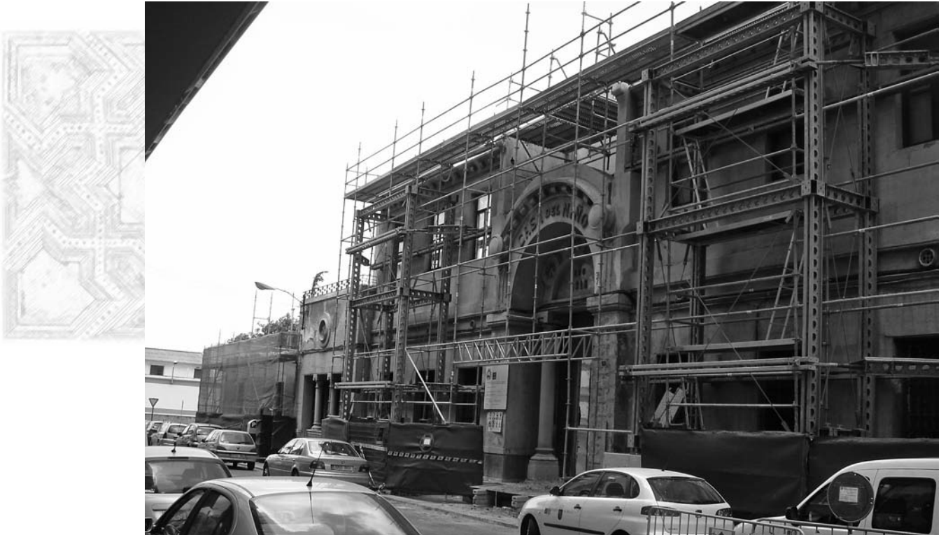
Lámina 1. Fachada principal de la Casa del Niño durante las obras de reforma, acondicionamiento y restauración para adaptarla al CEHIFORM.
