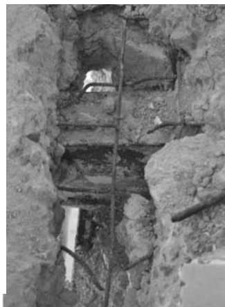
Lámina 4. Detalle de algunas de las catas realizadas en vigas y viguetas metálicas para comprobar el estado real de conservación previo a la intervención.
