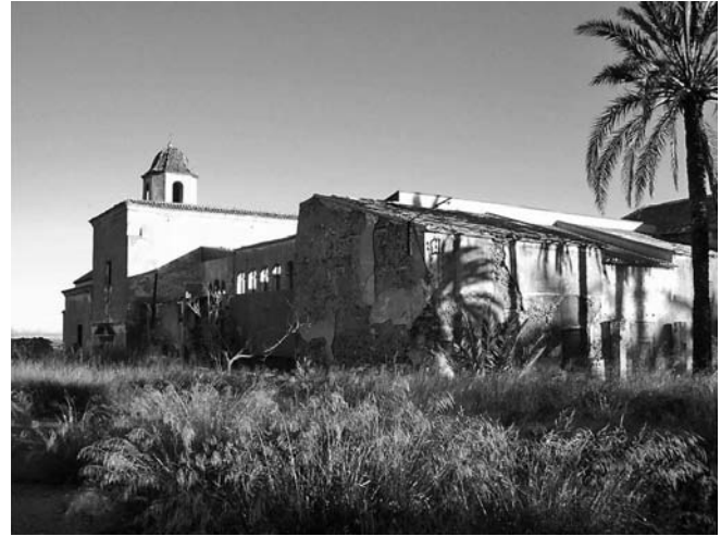
Lámina 2. Vista general del Monasterio de San Ginés de la Jara antes de la rehabilitación.
