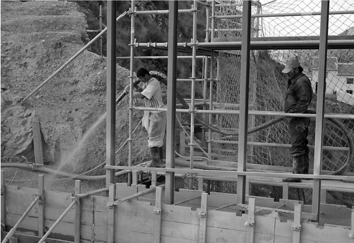
Lámina 5. Ejecución de muro de tapial. Se utiliza una bomba de proyectar hormigón y elementos del encofrado de muros para el encofrado (pasamuros), además para la compactación se utilizan vibradores propios de elementos de hormigón.
