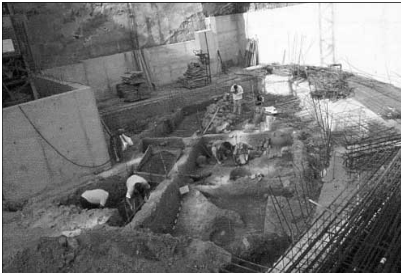
Lámina 1. En solar durante el proceso de excavación condicionado por las obras de cimentación previas.
