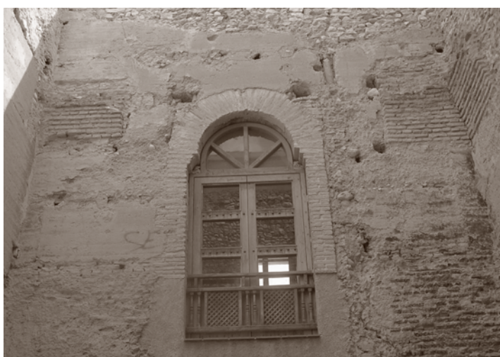
ÁLZADO A PATIO INTERIOR, A NIVEL DE PLANTA PRIMERA. ANTERIOR A LA INTERVENCIÓN
